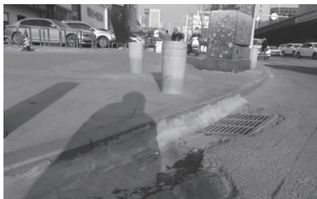
图1 路口未降坡,无障碍不完善
