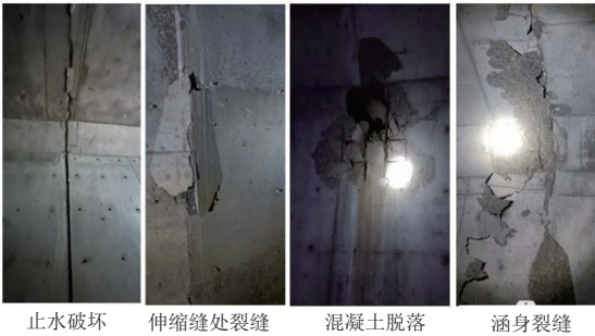
图2 箱涵其余 4 类损坏情况实景图
