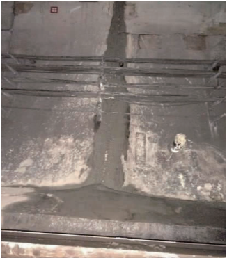
图4 隧道次生病害图
