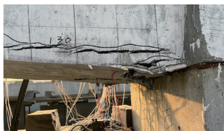
图14 分片盖梁缩尺试验模型破坏照片
