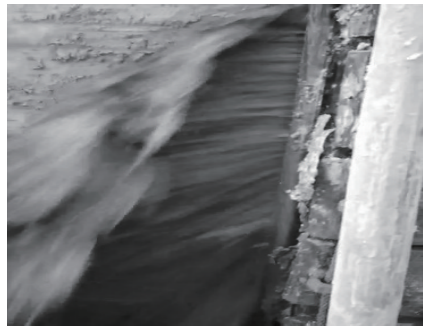
图 2 洞门帘布橡胶处涌水涌砂图
