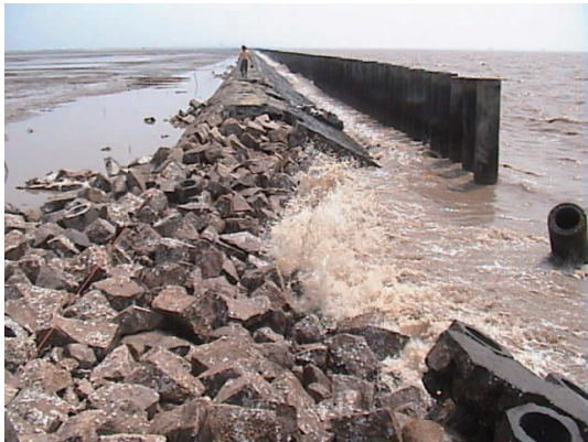
图 5 保滩工程坍塌险情
