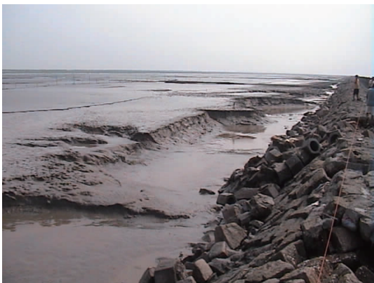
图 3 前沿滩地常见险情(冲刷逼岸)
