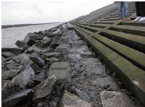
图 7 护脚结构大范围损坏险情
