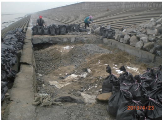
图 9 外坡结构大范围损坏险情
