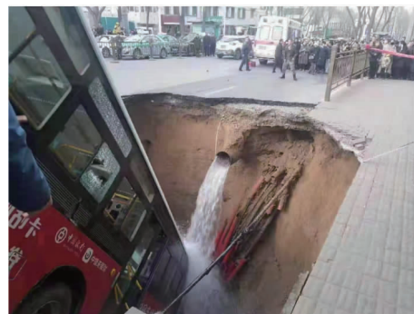
图1 西宁“1·13”路面塌陷重大事故
