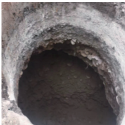
图7 现场塌孔照片
