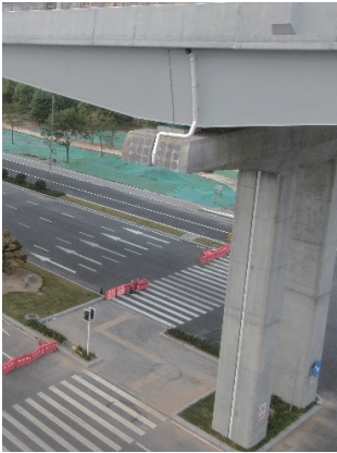
图 12 半隐藏式排水管实景图
