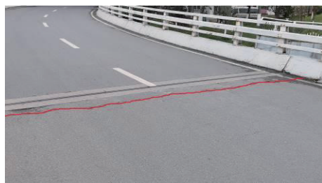
图9 2020年0号桥台顶路面局部下沉开裂
