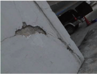
图 4 0 号桥台右侧墙裂缝图
