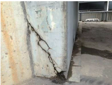
图 5 2017 年 0 号桥台裂缝
