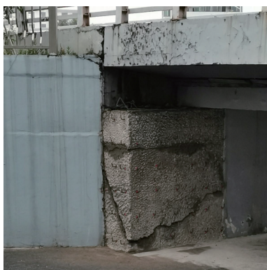
图8 2020年0号桥台凿毛后裂缝正面
