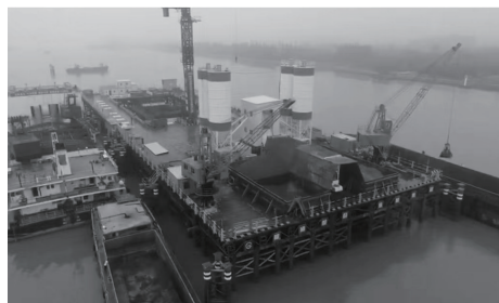
图7 克令吊实景图
