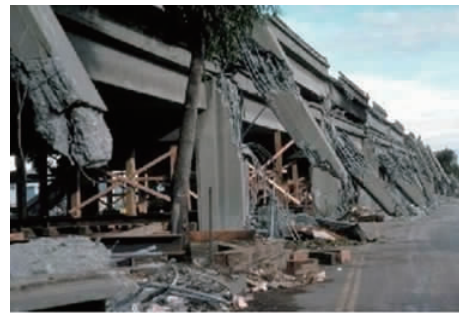
图 1 柏林街双层高架桥倒塌图一
