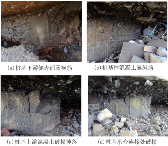
图1 浦上大桥水下病害 表1 浦上大桥桩基病害情况
