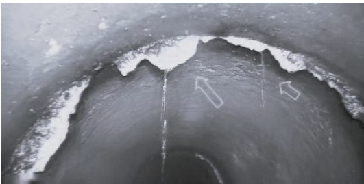
图4 污水管段G-H CCTV检测照片
