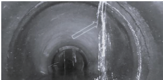
图2 污水管段C-D CCTV检测照片
