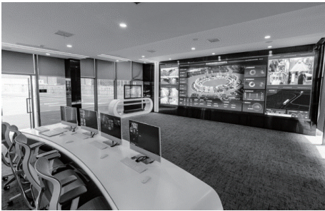
图 11 监控智慧中心实景图
