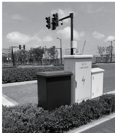
图10 路侧设施现场实景图
