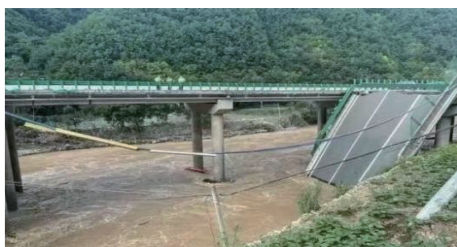
图1 陕西柞水高速公路桥梁坍塌
