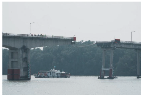
图3 沥心沙大桥坍塌
