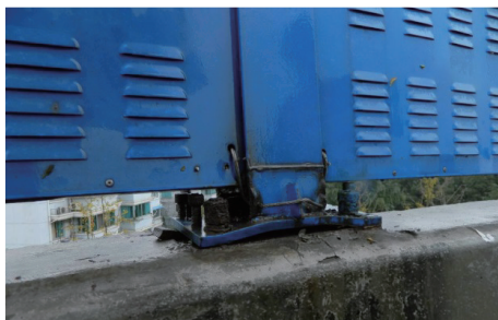
图2 声屏障立柱底板变形
