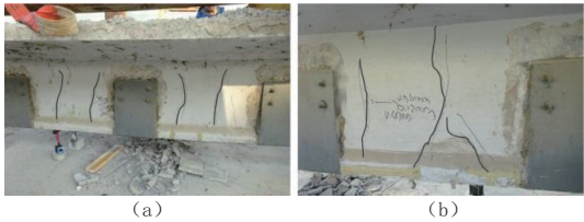
图 9 加固梁受弯区腹板两侧裂缝
