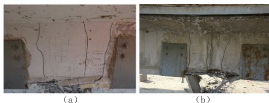
图7 未加固梁受弯区腹板两侧裂缝
