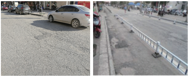
(a) 路面裂纹病害
