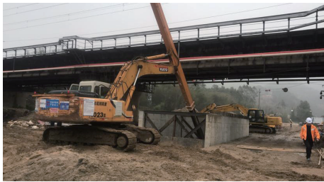
图5 框架侧墙不排水下沉
