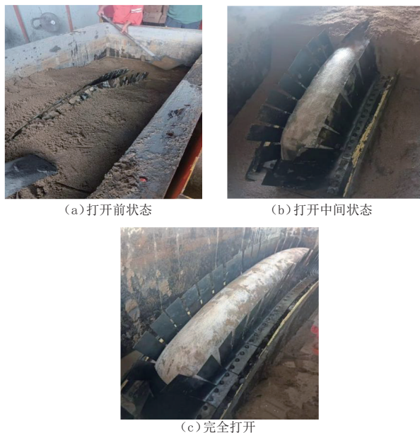
图11 有外荷载下的等比例附囊袋钢管片注浆打开试验
