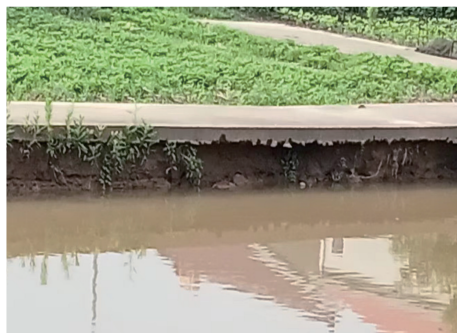
图6 砂性土侵蚀造成邻河道路悬空(渡港)
