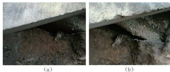
图3 桥头搭板侧面脱空
