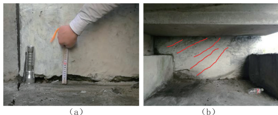
图1 桥台背墙现场照片
