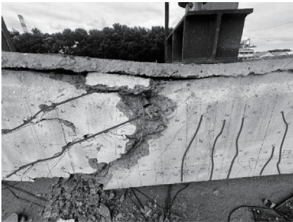
图5 试验组 3B 破坏情况现场实拍
