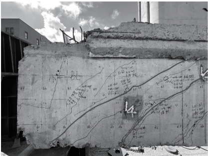
图4 试验组 1B 破坏情况现场实拍
