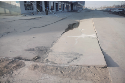
图1 地面下沉导致硬化层开裂
