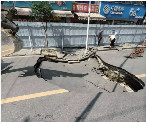
图2 “2024.7”地面塌陷现状
