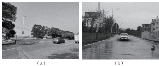
图2 荔港大道不均匀沉降和积水照片
