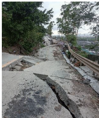
图3 K5+200~K5+360段道路沉降位移实景
