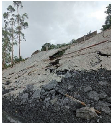
图2 道路边坡滑移实景
