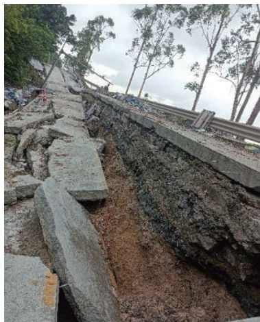
图4 K5+360~K5+490段道路沉降位移实景
