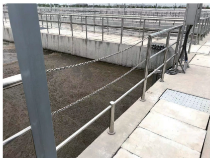
图1 一期生物反应池液面浮渣
