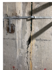
图1 某综合管廊变形缝拉裂图
