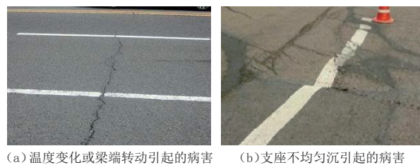
(a) 温度变化或梁端转动引起的病害 (b) 支座不均匀沉引起的病害
