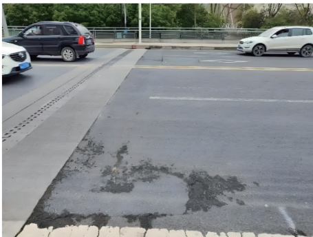
图2 伸缩缝处沥青路面因积水损坏
