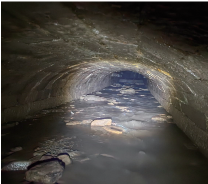
图 1 石拱涵未坍塌段内部照片
