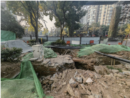
图 2 地表塌陷照片
