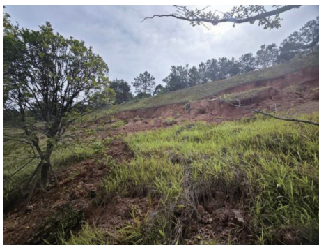
图 2 边坡垮塌现状图
