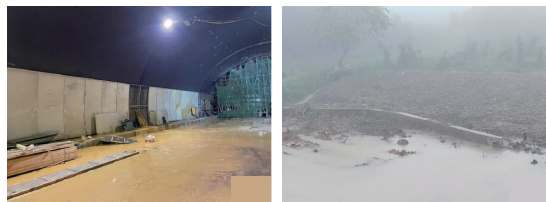
(a)隧道内渗水加剧情况 (b)地表落水洞堵塞后大面积积水 图4 城区地表塌陷阻塞后地表积水及隧道内漏水加剧
