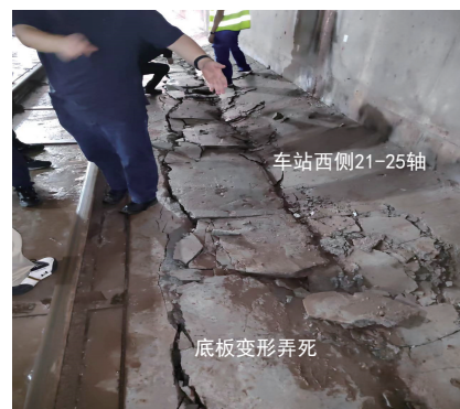
图2 车站轴西侧19-25C轴变形开裂照片
