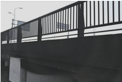
图 10 桥面栏杆熏黑
