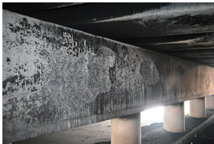
图 8 1#桥墩盖梁北侧面混凝土局部剥落
