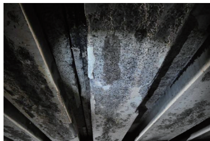
图3 梁底及梁间湿接缝大面积剥落露筋
