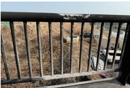
图 11 栏杆熏黑、油漆脱落
