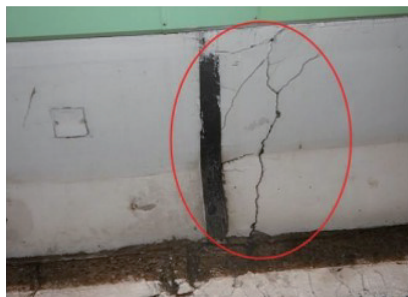
图2 防撞墙接缝处受挤压开裂
