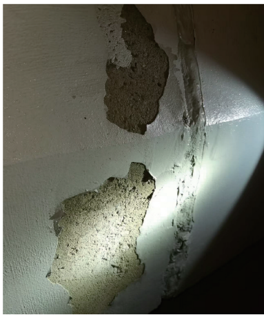
图1 防撞墙混凝土表面局部松散
