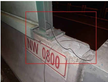
图7 防撞墙上声屏障钢丝断裂、构件缺失
