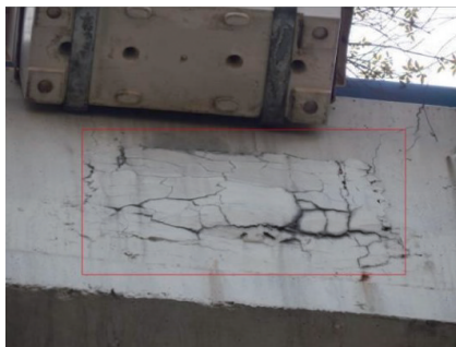
图3 防撞墙锈胀开裂,存在坠落风险
