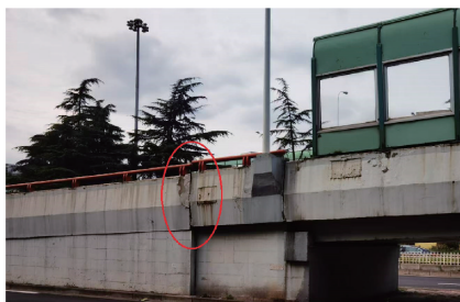
图4 落地段防撞墙因沉降差出现竖向开裂
