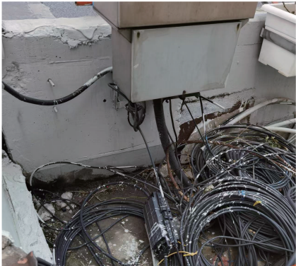
图6 管线无法在防撞墙管道内敷设
