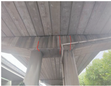
图 2 内圈 83#盖梁小桩号侧裂缝示意图
