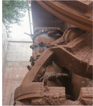
图 31 贯通截齿脱落照片
