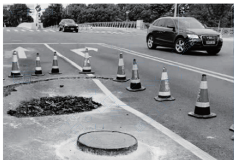
图 1 申昆路道路塌陷前现状
