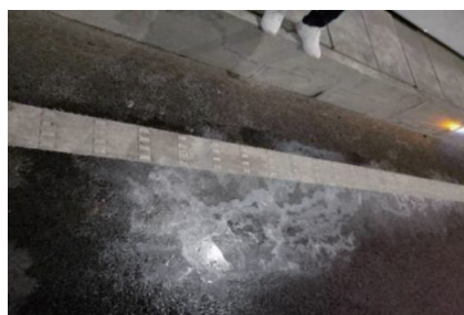
图3 隧道路面渗水
