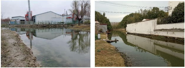
图2 河道岸坡水体流失
