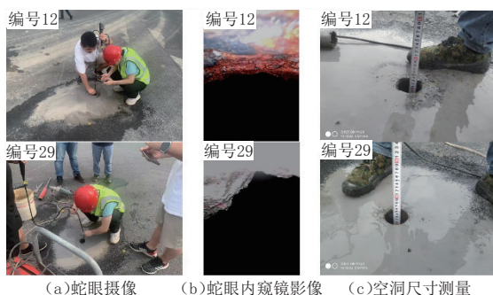
图8 空洞隐患现场复测及钻芯验证
