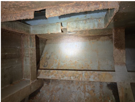
图1 弧形闸门舱内腐蚀实景
