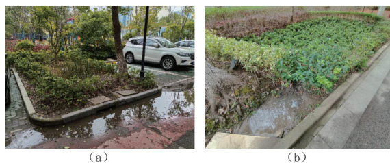
图11 施工精度差导致无法有效收水
