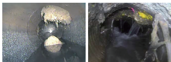
(a) CCTV 缺陷照片截取
