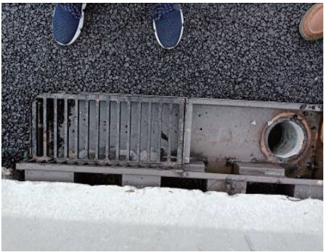
图4 收水口和集水井实物图
