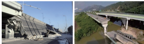
图1 桥梁倾覆事故
