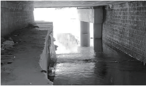
图5 污水外溢污染河道
